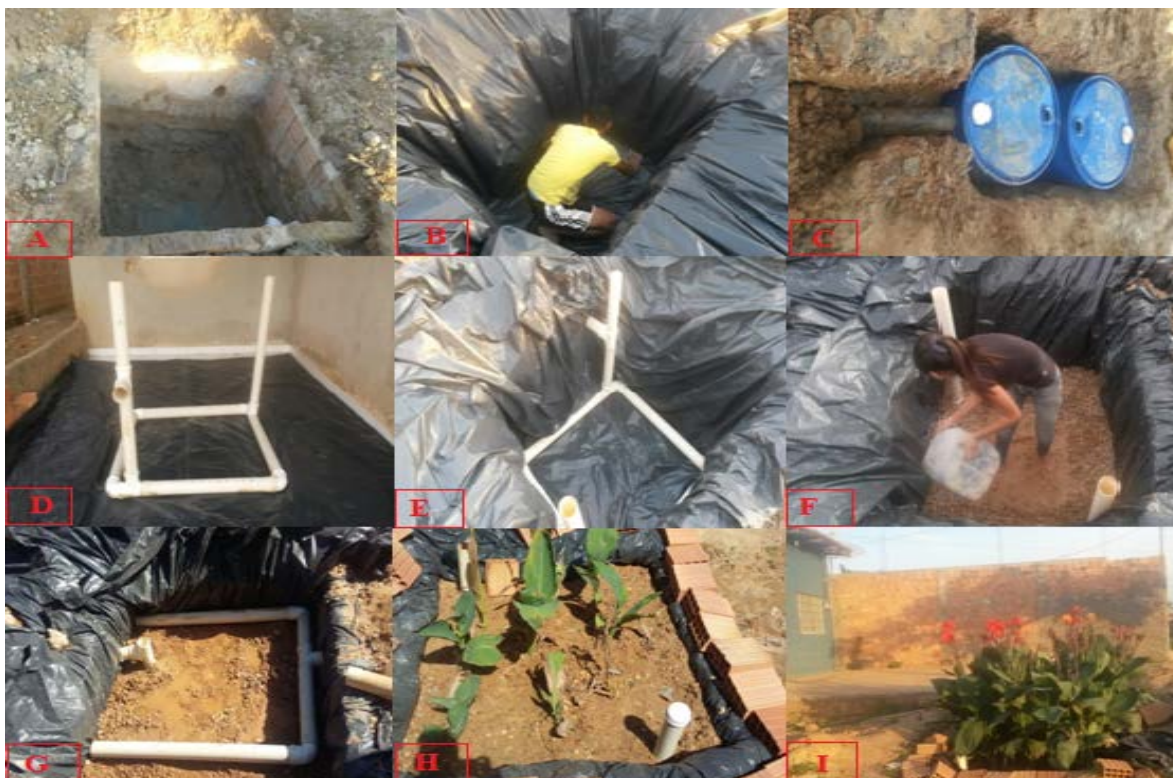
Figura 02: Esquema de construção da Estação de Tratamento de Esgoto por Zona de Raízes.
