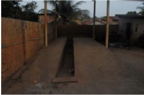
Figura 02: Rampa de lavagem.
