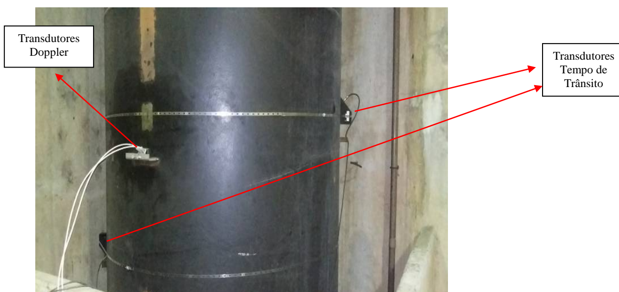
Figura 7: Instalação dos transdutores Doppler e Tempo de Trânsito
