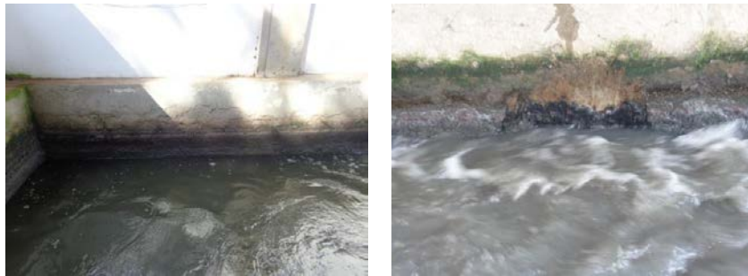
Figura 7: Parede do Canal de Chegada do Tratamento Preliminar
