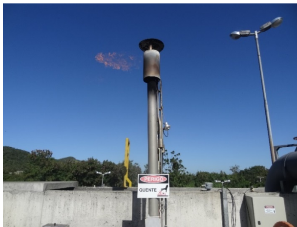
Figura 6 - Queimador de biogás
