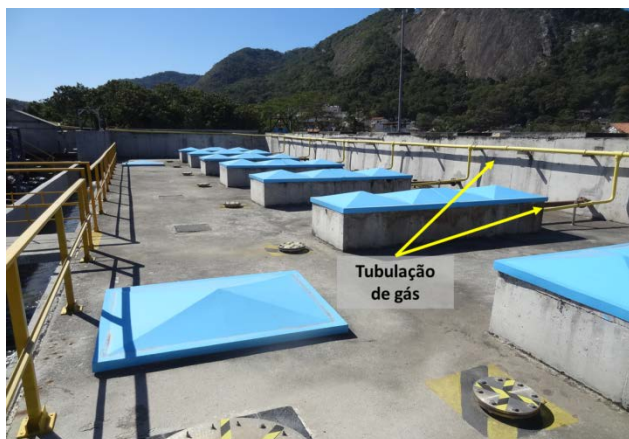
Figura 3 - Tubulação de coleta de gás
