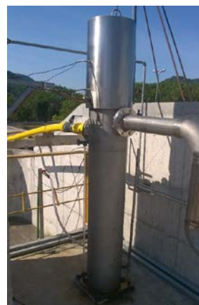
Figura 4 - Selo Hídrico da ETE Itaipu
