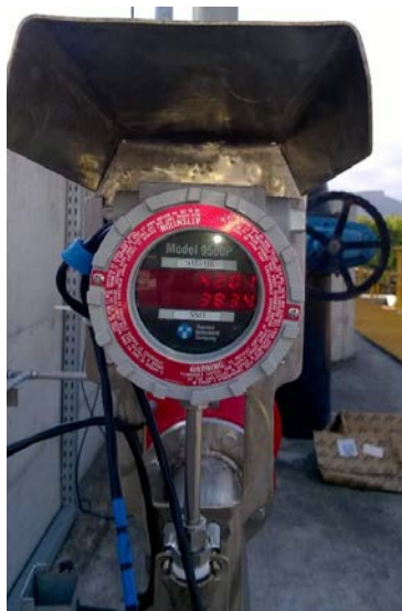
Figura 5 - Medidor de vazão de biogás
