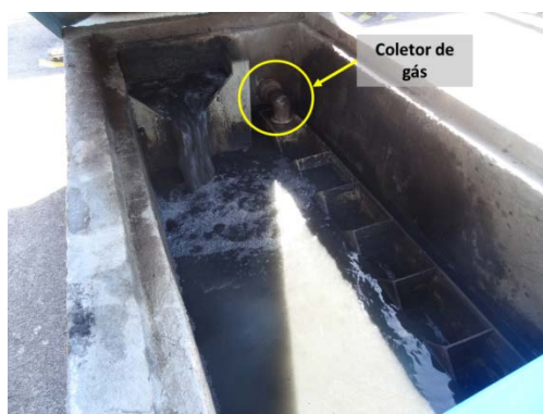
Figura 2 - Coletor de biogás
