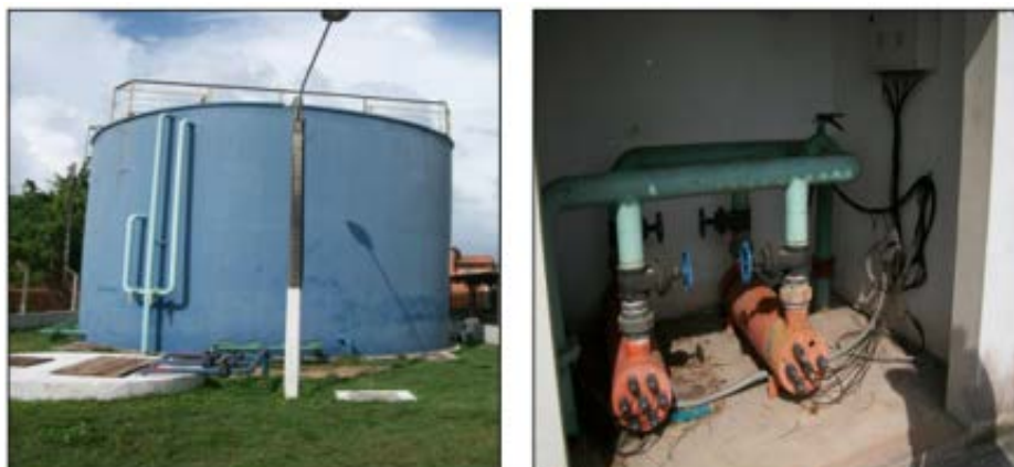
Figura 1. Reator Aeróbio e Anaeróbio junto ao sistema UV. Fonte: COSANPA (2012).
