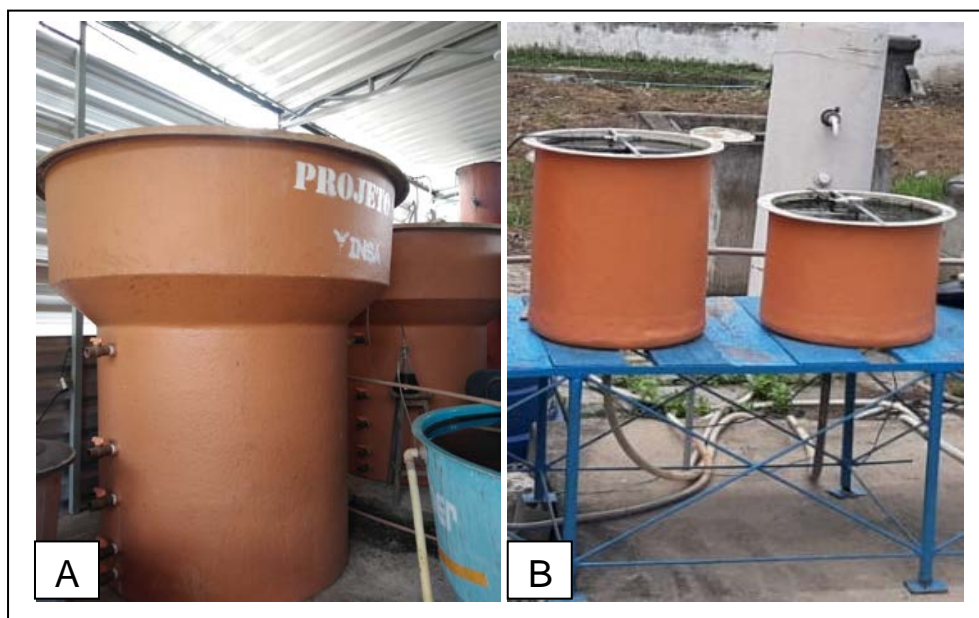
Figura 1: Reator UASB em operação na estação experimental (A); Lagoas de Polimento (B).
