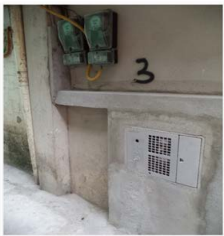
Figura 09 – Caixa UMA instalada
