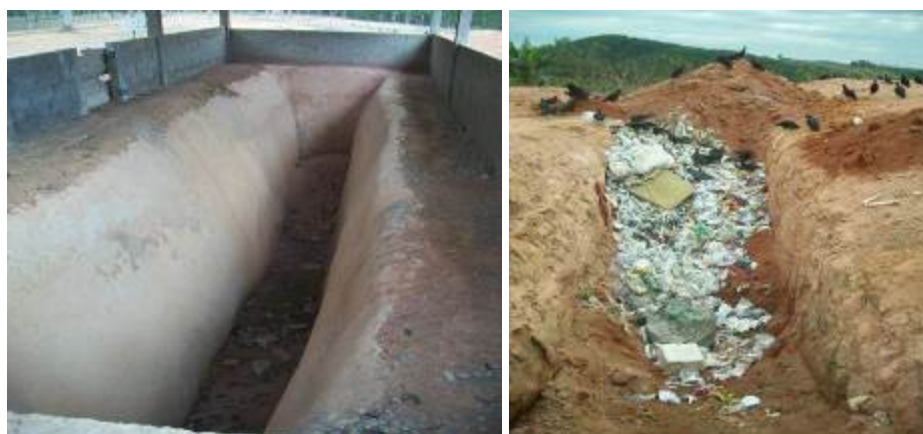
Figura 6 - Vala para resíduos de saúde com delimitação (muro) e telhado (à esquerda) e vala de rejeitos (à direita), ambas mal operadas (sem cobertura, sem compactação, sem drenagem), em Divinésia Fonte: Autores (2017)
