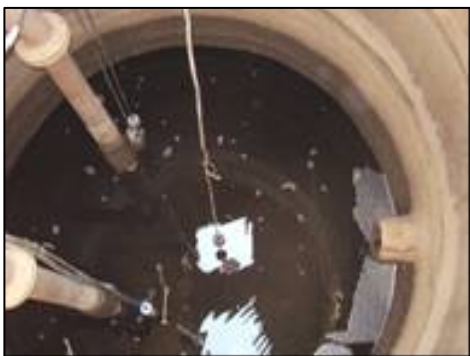
Figura 1a. Vista do poço de recalque onde se coletava o afluente ao sistema de tratamento.
