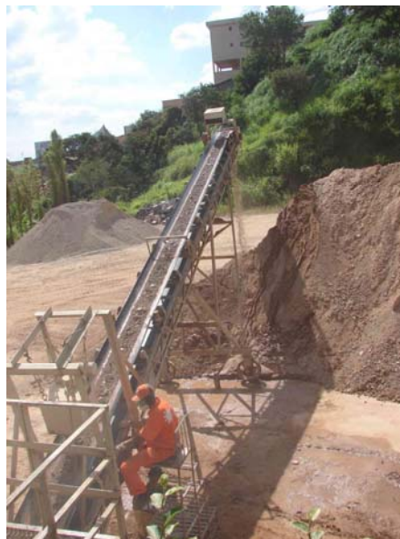
Figura 3 – Britadeira na Estação de Reciclagem Estoril – Belo Horizonte – MG
