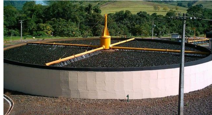
Filtros biológicos percoladores (nitrificação apenas parcial; mais elevada com meio sintético)
