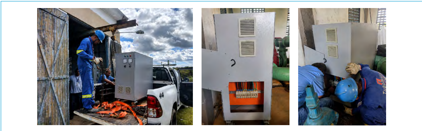
Figura 5 - Instalação do regulador BT/BT
