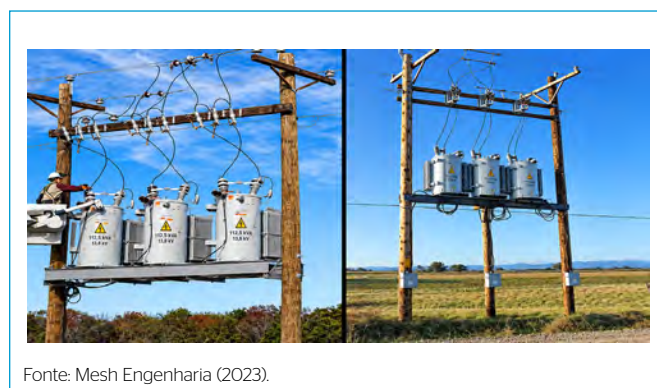
Figura 2 – Regulador de tensão instalado na rede de distribuição
